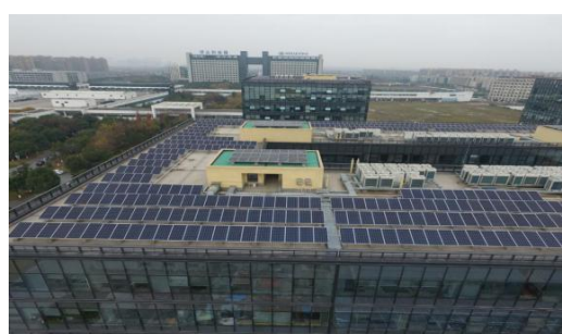
屋顶光伏发电
