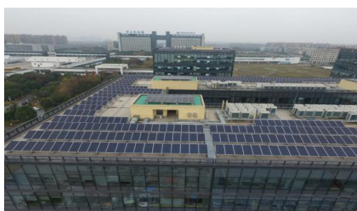
屋顶光伏发电
